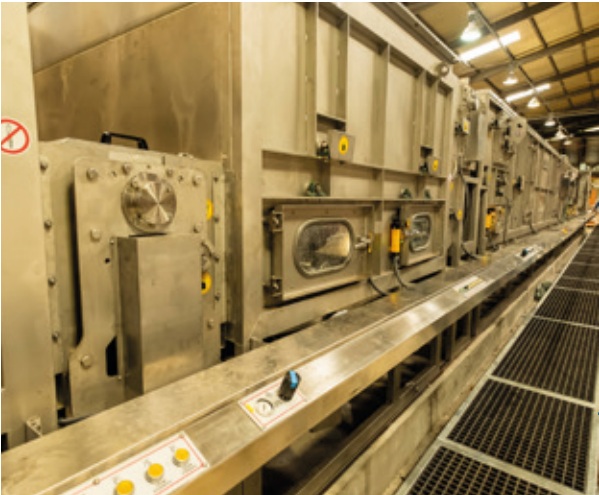
Lavadoras de tingimento: usam menos água para lavar os tecidos do que se o processo completo fosse realizado nas máquinas de tingir.
